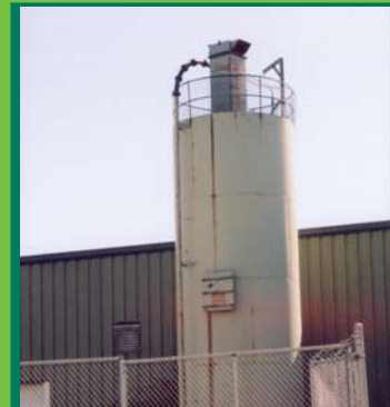
100 TON SILO W/BIN VENT
