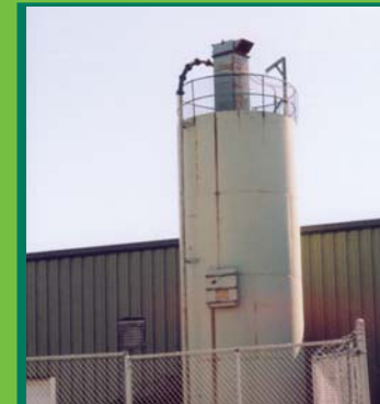
100 TON SILO W/BIN VENT
