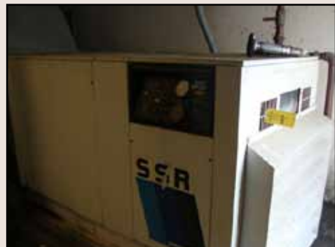
INGERSOLL-RAND AIR COMPRESSOR
