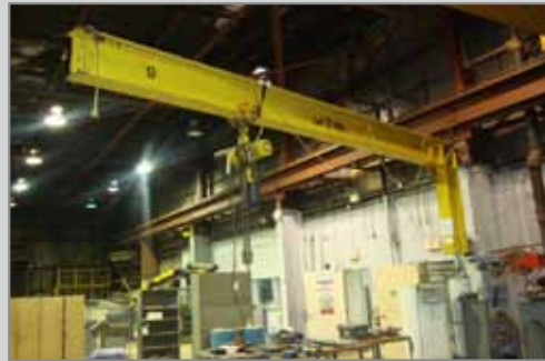
(10) 2 TON JIB CRANES
