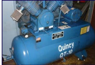
QUINCY QT-10 HORZ. AIR COMPRESSOR
